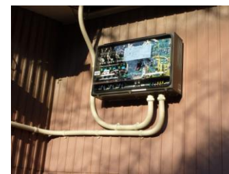
外壁にパワーコンディショナー
