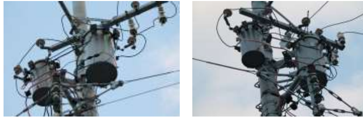
バンク割の事例か確認できないが2台の変圧器が併設されている事例
