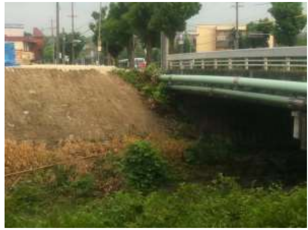
新坂下橋南側(土砂投棄).
