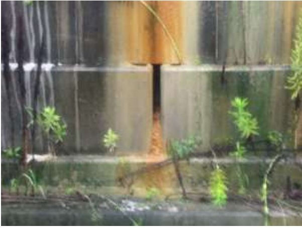
西側擁壁(隙間からの土の流出)
