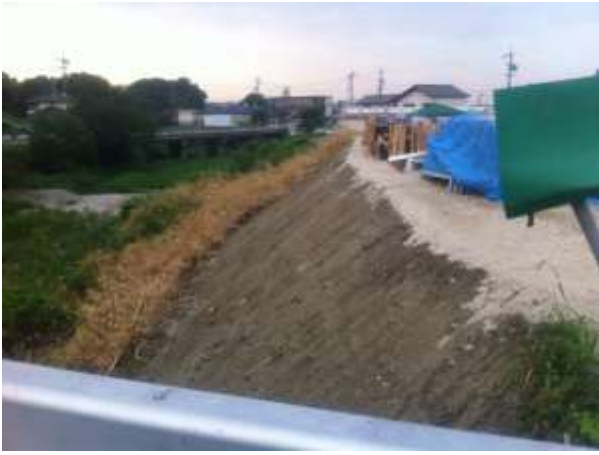
新坂下橋南側(土砂投棄)
