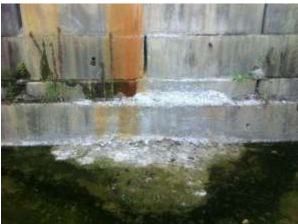
西側擁壁(神屋川への生コンクリート流出)
