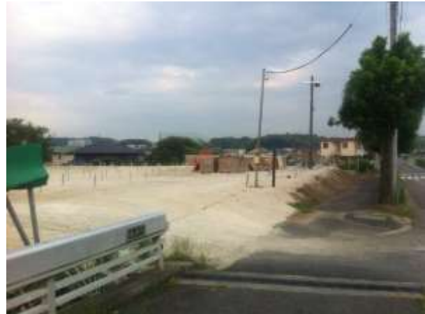
施設北側道路面(敷地内盛土の市道への流出)
