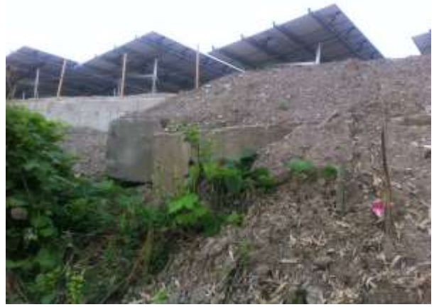
堤防道路(擁壁用コンクリート製ブロック放置)
