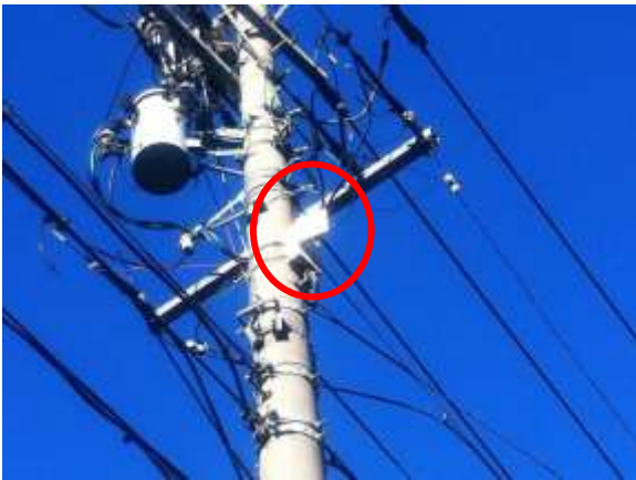
柱上トランス
